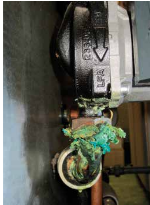
Efflorescence de l'inhibiteur sur une bride.
