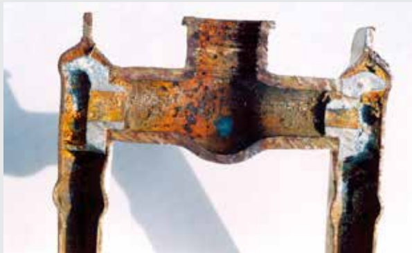
Obstruction d'un radiateur par le dépôt de sels provenant d'un inhibiteur qui contient des impuretés.
